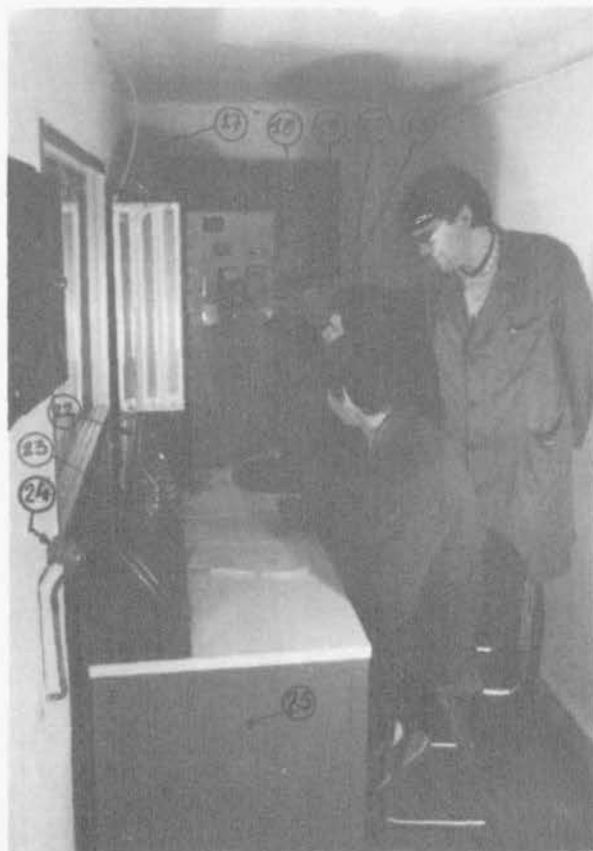
17. Manómetros de columna. 18. Tacómetro. 19. Aparato de medida del par. 20. Medida de temperaturas. 21. Central de alarmas. 22. Consola mando acelerador y freno. 23. Consola arranque del motor. 24. Llave de tres vías para el combustible. 25. Mesa pupitre.
